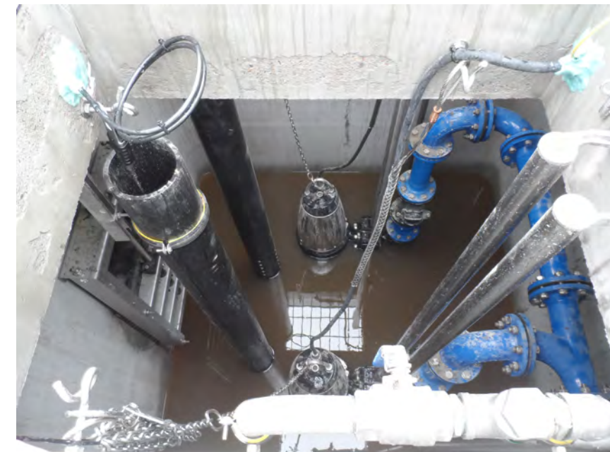
Interieur van het gemaal aan de Durgerdammerdijk
