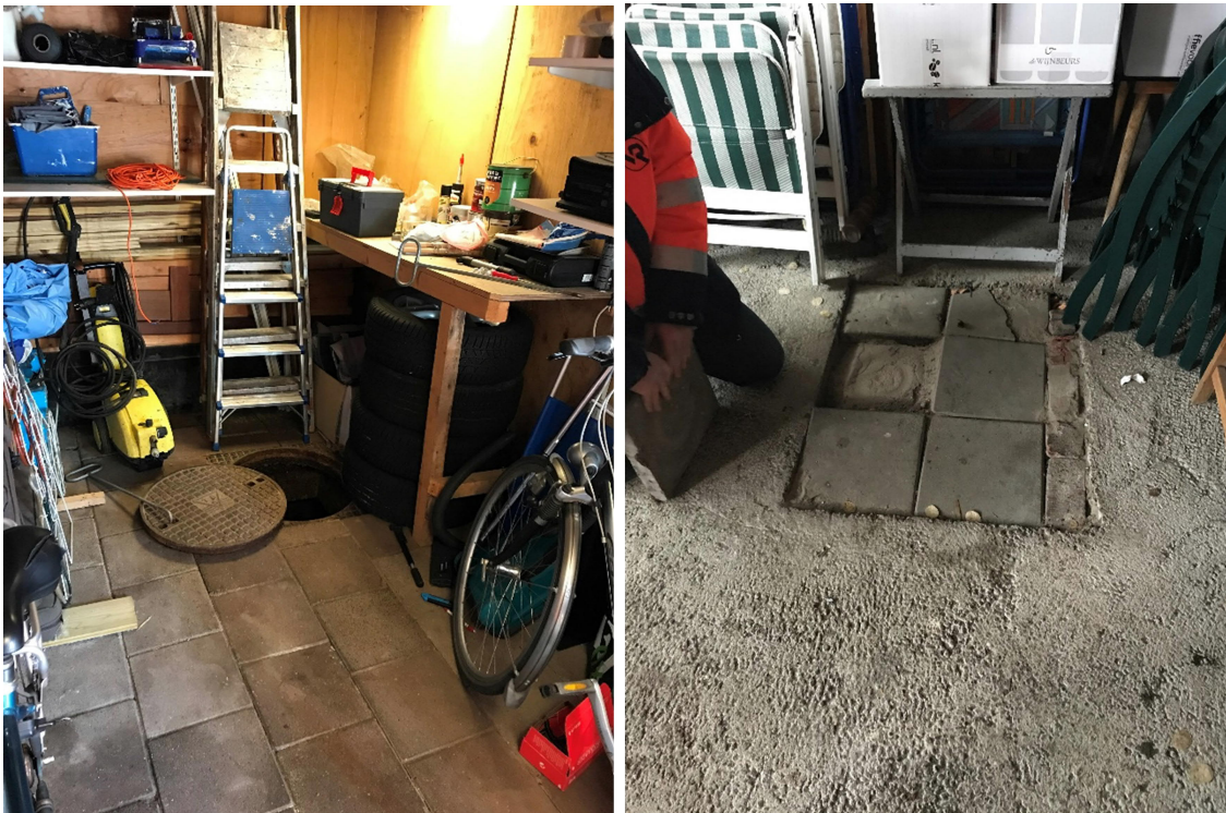
Figuur 1, Voorbeelden van de slechte bereikbaarheid en toegankelijkheid van het riool
