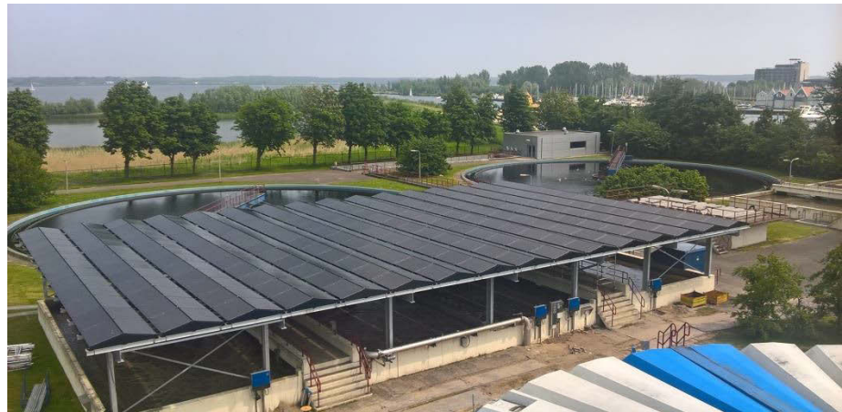
Zonnepanelen op de beluchtingstank van rioolwaterzuiveringsinstallatie Huizen
