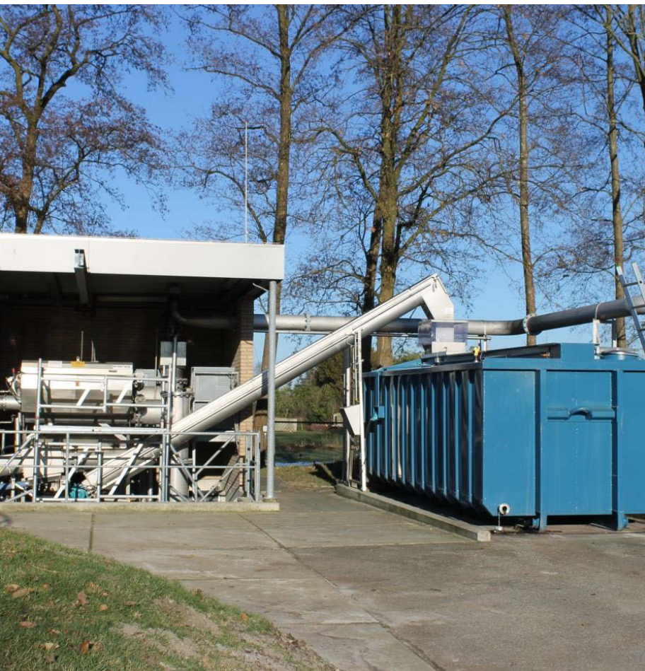
Fijnzeefinstallatie rwzi Blaricum
